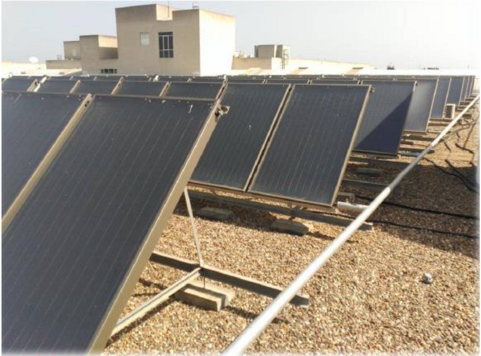
Figura 2.- Captadores solares en el Hospital Juan Ramón Jiménez de Huelva
