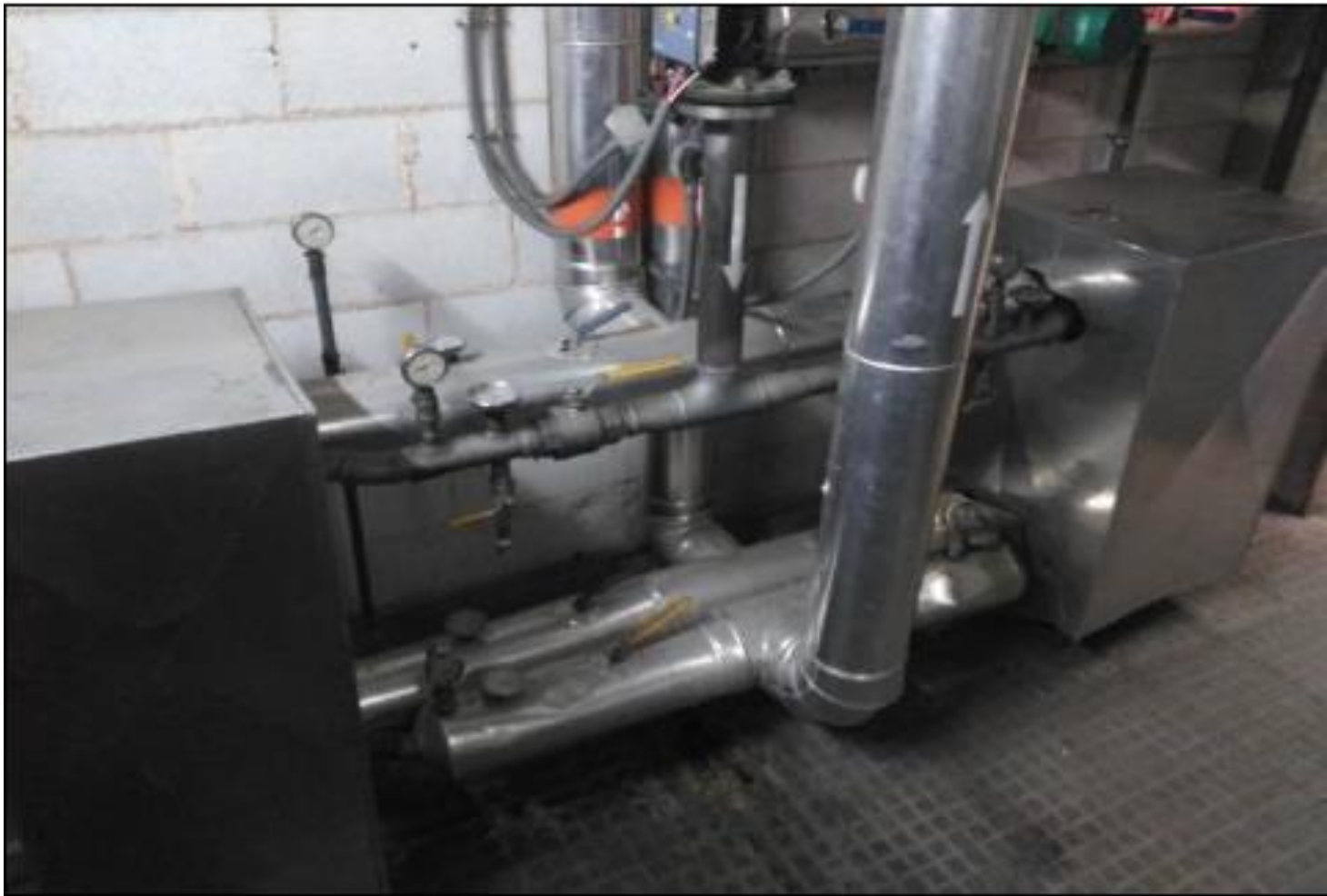
Figura 4.- Intercambiadores de placas en el circuito secundario
