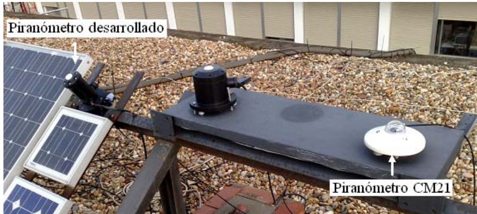
Figura 5.5. Ubicación de los piranómetros en la instalación.
