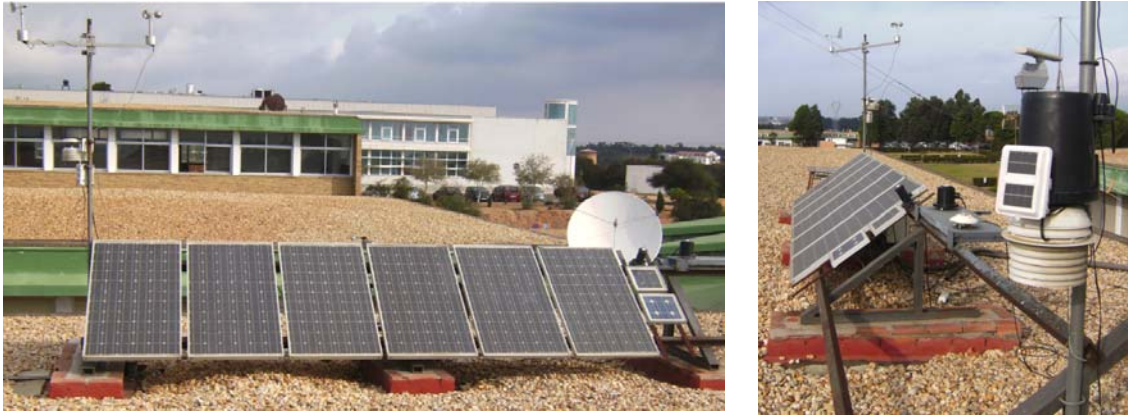
Figura 5.1. Detalles de la instalación fotovoltaica de experimentación en la E.T.S.I. de la UHU.
