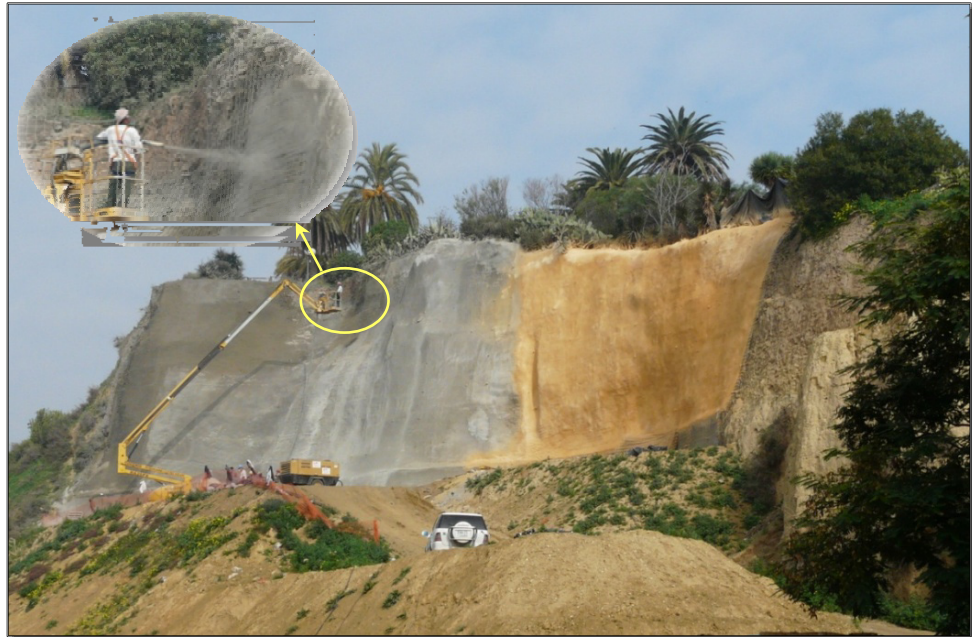
Figura 5. Panorámica de las obras de estabilización del talud formado por la Unidad Arenas Huelva-Bonares en la calle Aragón de la ciudad de Huelva.
