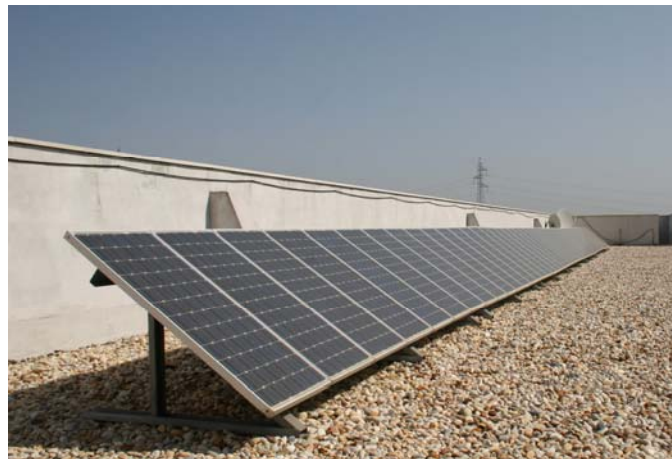
Figura 4.27. Instalación fotovoltaica medida.
