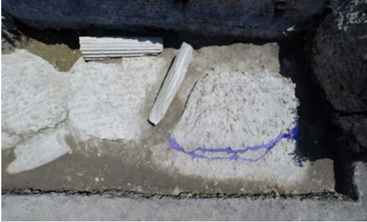
Figura 14. Foto detalle del derrumbe occidental en el que se pudo apreciar el desprendimiento conjunto de la pared del muelle y las estructuras arquitectónicas de la parte superior.
