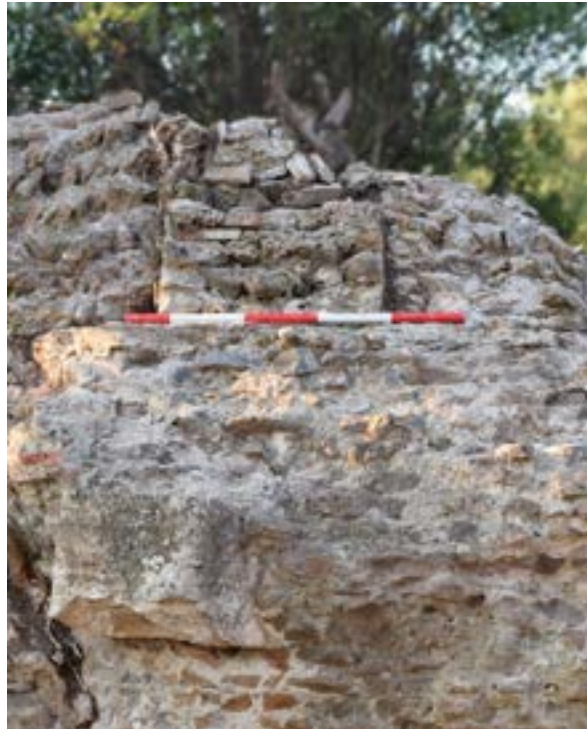
Figura 20. Amortización de uno de los muros de la primera fase en la nueva estructura turriforme.
