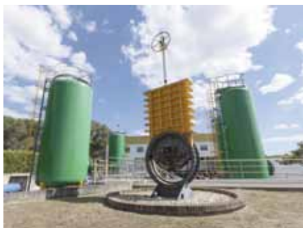
Figura 62. Estación de bombeo. C.R. Surandévalo
