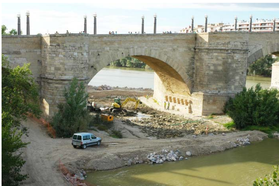
Inicio de los trabajos para el canal de navegación bajo el Puente de Piedra (agosto de 2007)
