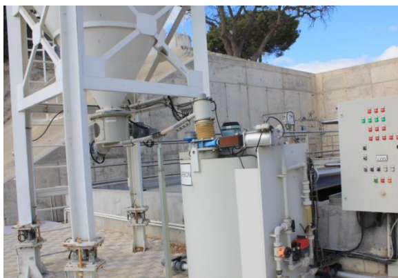
(A) Silo almacén y dosificación de PAC
