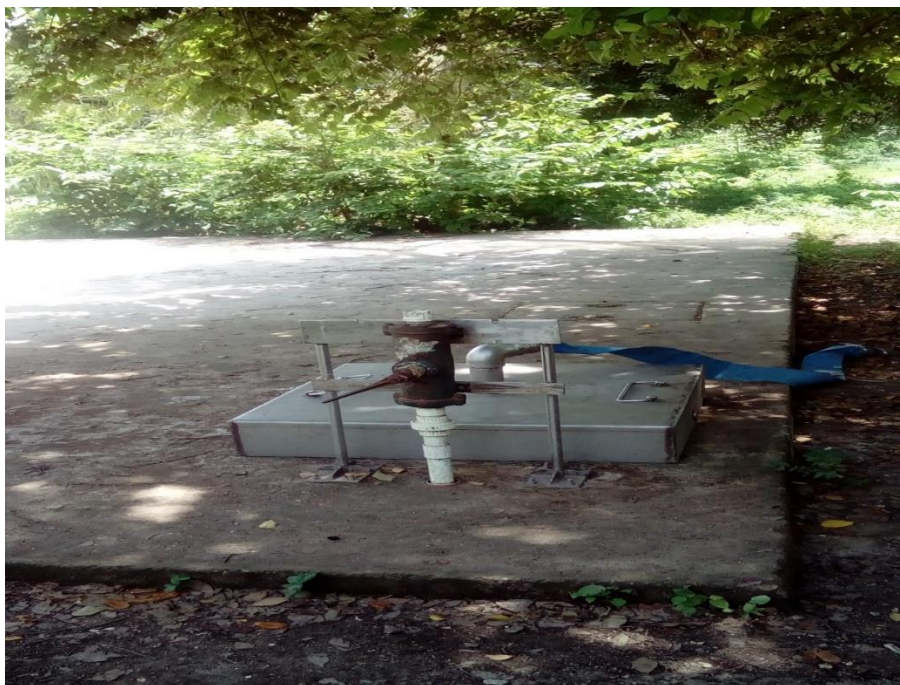
Figura 19. Aljibe para abastecimiento de agua potable en Isla Grande
