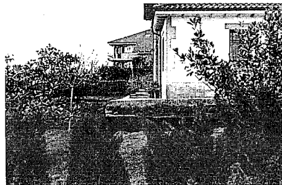
Foto 1.- Hundimiento en la coronación del deslizamiento A, afectando a la vivienda 2.
