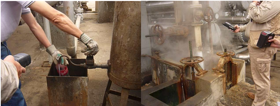
Figura 56.- Puntos de toma de muestras, en las que se libera el contaminante, pasando directamente a la atmósfera del lugar de trabajo
