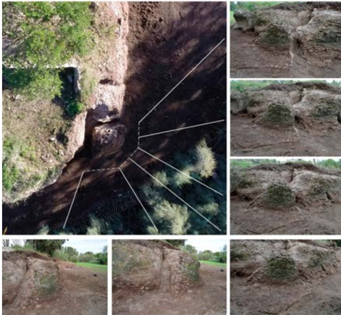
Figura 51. Vista general y de detalle de la fractura de la plataforma adosada.
