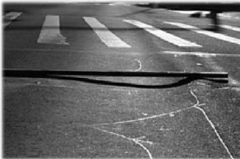
Figura 2.6 Deformación permanente en carreteras.
