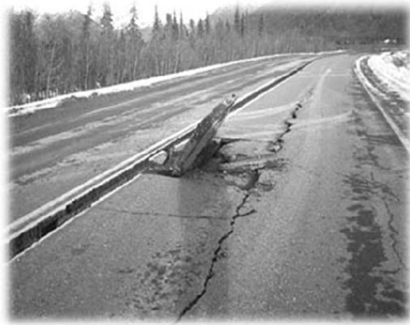
Figura 2.7 Fractura de carreteras.
