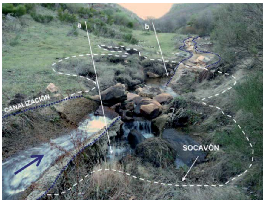
Fig. 2.- Fractura de la canalización sobre el socavón de mayor cota en el arroyo de Alcedo. En la fotografía se observan dos sumideros activos (a y b).
