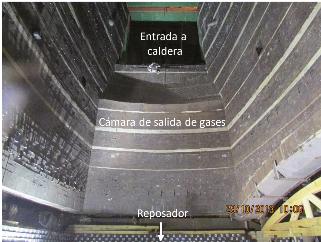
Fig. 1.30.: Vista interior de la instalación de refractario en la cámara de salida de gases de un Horno Flash. Imagen obtenida por colaboración de Atlantic Copper (Huelva, España).
