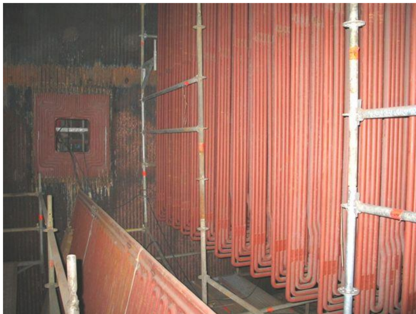
Fig. 1.12.: Vista interior de caldera recuperadora de calor que trata gases de la fusión en Horno Flash en Atlantic Copper.
