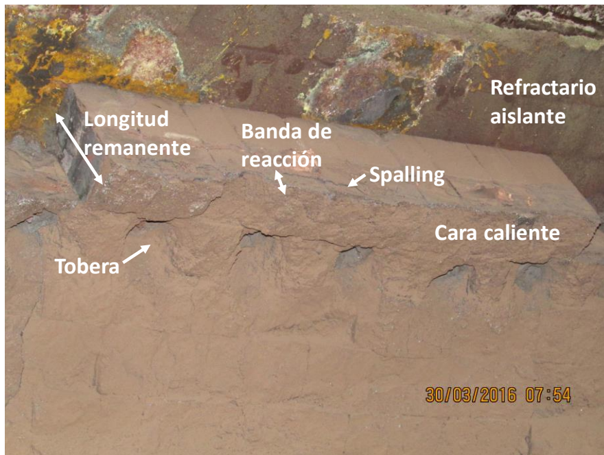
Fig. 4.28.: Refractario remanente en la zona de toberas del PSC estudiado. Se muestra el spalling sufrido debido a la banda de reacción formada en la cara caliente.
