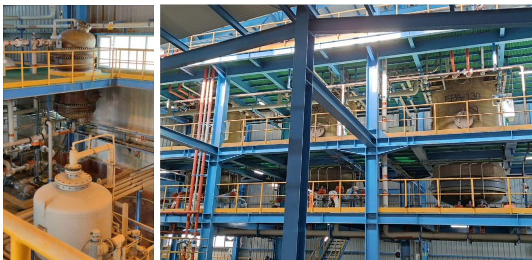
Figura 57. Planta industrial de eliminación de Sb/Bi instalada en Atlantic Copper. Figura de la izquierda: columna con virutas de cobre y figura de la derecha: columnas con resina de IX (fuente: Atlantic Copper).
