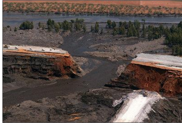
Figura 18. Rotura del muro de contención de la balsa minera de Aznalcóllar.
